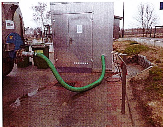
Stacja zlewna na terenie oczyszczalni ścieków
